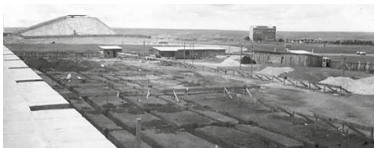
Início das obras da sede do Touring Club em Brasília, 1964. Fonte: Acervo Touring Club do Brasil
